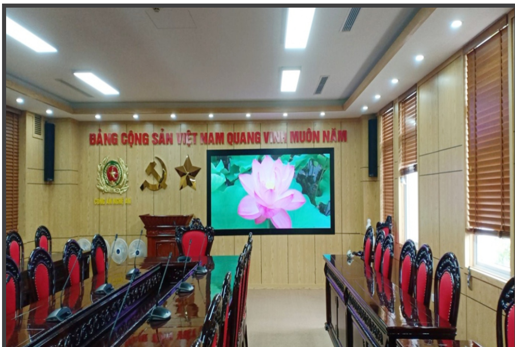
MÀN HÌNH P2.5 INDOOR - PHÒNG HỌP TRỤ SỞ CÔNG AN TỈNH NGHỆ AN
